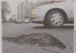
Am Olof-Palme-Platz hat die Straßendecke tiefe Löcher
