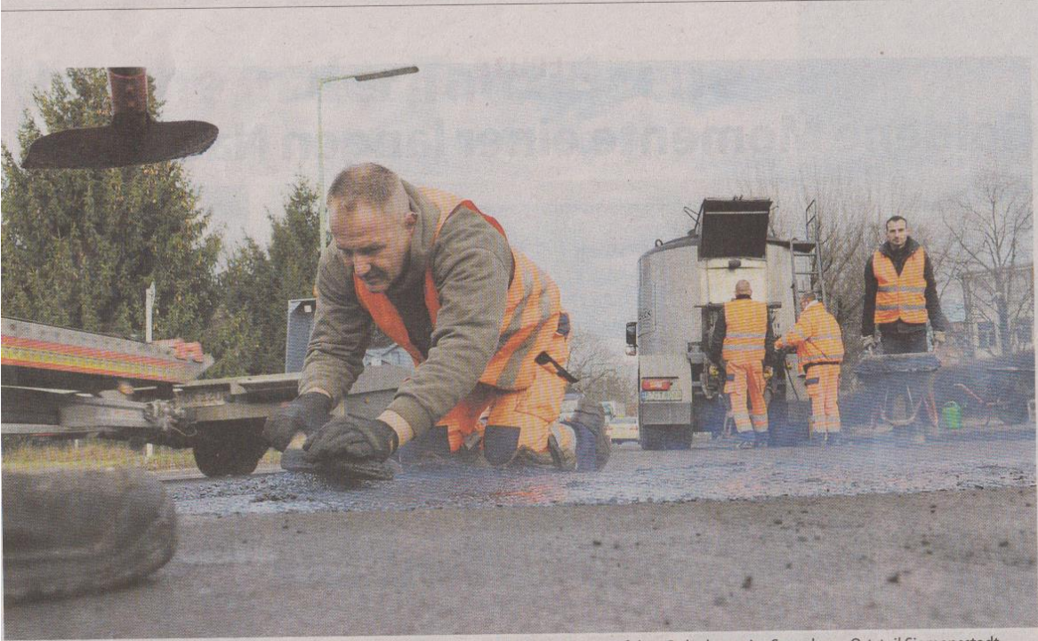
Die Teermaschine ist im Dauereinsatz: Eine Straßenbaufirma saniert Fahrbahnschäden auf dem Rohrdamm im Spandauer Ortsteil Siemensstadt
